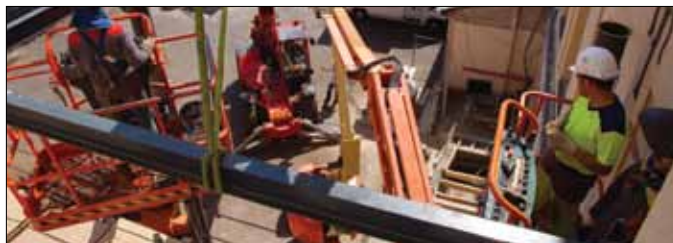
Les travaux en cours. Pose de poutrelles pour l'installation de coursives. (Photo E. Touvet)
